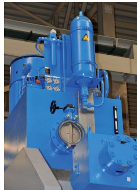
Door verschillende slimme constructieve oplossingen was het mogelijk de hydrauliekunit in een beperkte ruimte onder te brengen én toegankelijk te houden voor onderhoudswerkzaamheden
