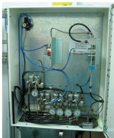
De kleppenkast in geheel explosievrije uitvoering met teflonleidingen voor de harder omdat deze niet in aanraking mag komen met water (foto: Judith Rissewijk)
