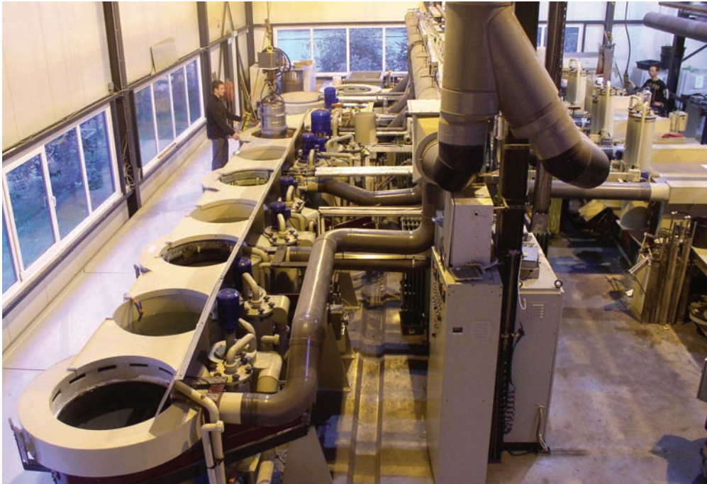
De nieuwe coatinglijn bij WMV kan nu ook grotere producten voorzien van de Lunac-coatings (foto: WMV)
